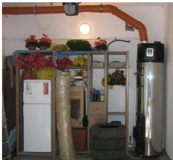
Pompa ciepła zamontowana w garażu:
